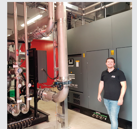
Inbetriebnahme vor Ort mit einem unserer Mitarbeiter
