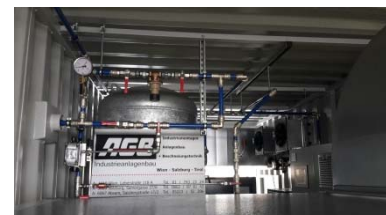
Druckluftsondercontainer mit 2 x Kompressoren á 22 kW für Israel
