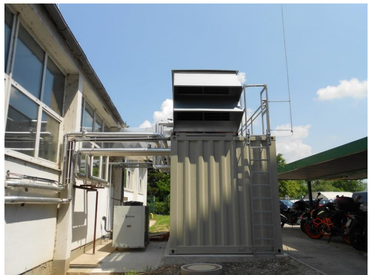
Außenansicht Zu- und Abluft inkl. Container
