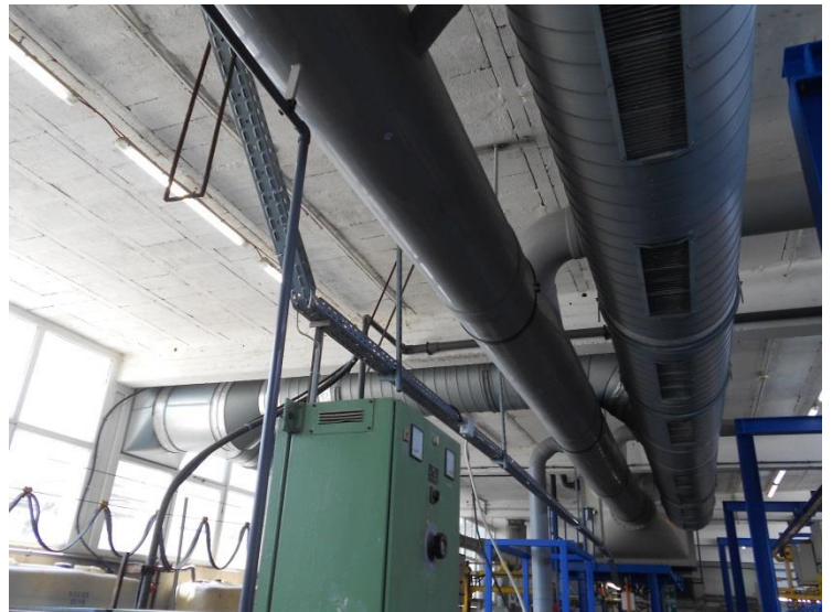
Innenansicht Verrohrung Richtung Container
